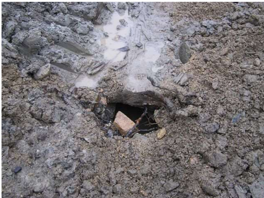
Příklad poruchy napojení betonového potrubí na původní dřevěné.
